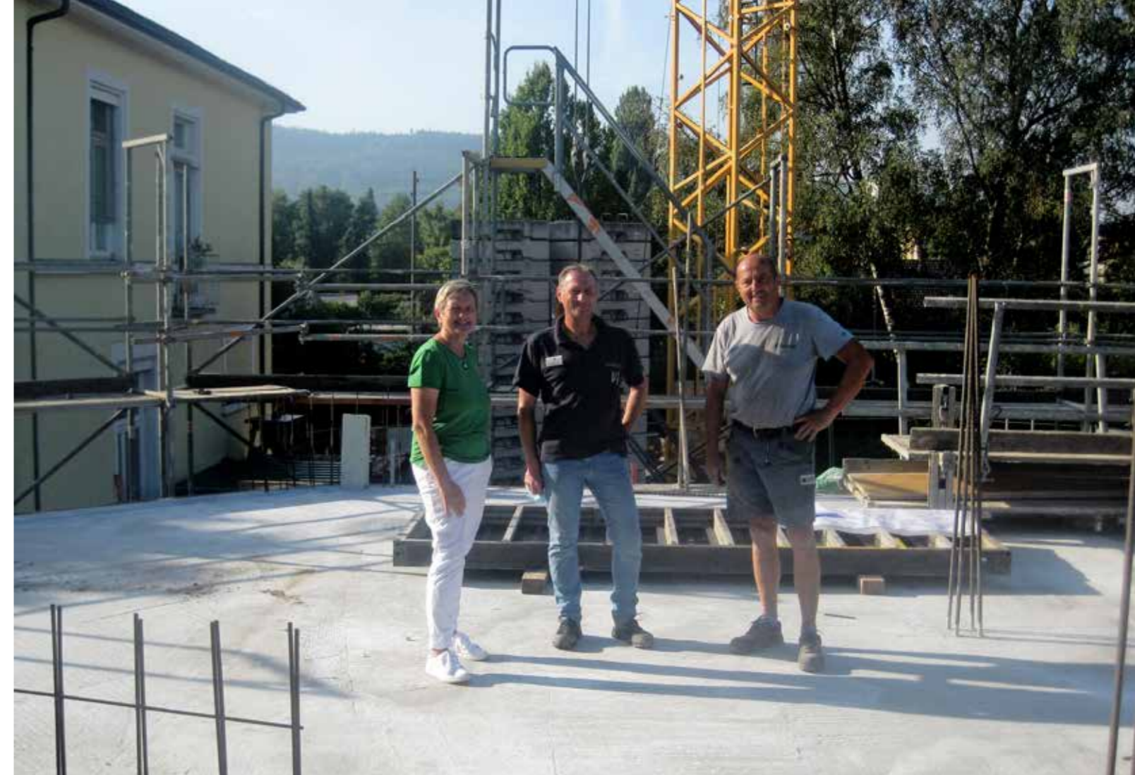
Frau Meßmer und Herr Kaltenbrunner mit Polier Herrn Mattheis vom Bauunternehmen Stocker bei der Baustellenbesichtigung
