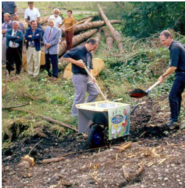
Spatenstich Jan ten Brink-Haus mit ehem. Bürgermeister Ottmar Kledt und Willy Wagenblast ehem. Geschäftsführer der KEG.
